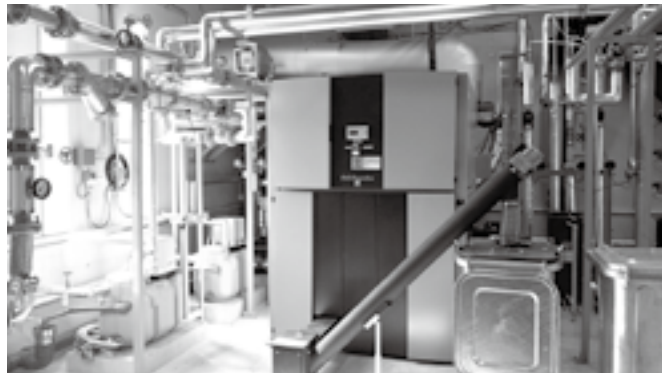
熱供給設備（バイオマスボイラー）
