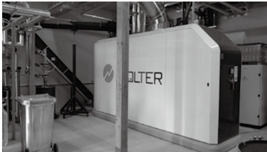
熱電併給設備
