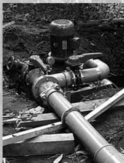
小型水力発電機
