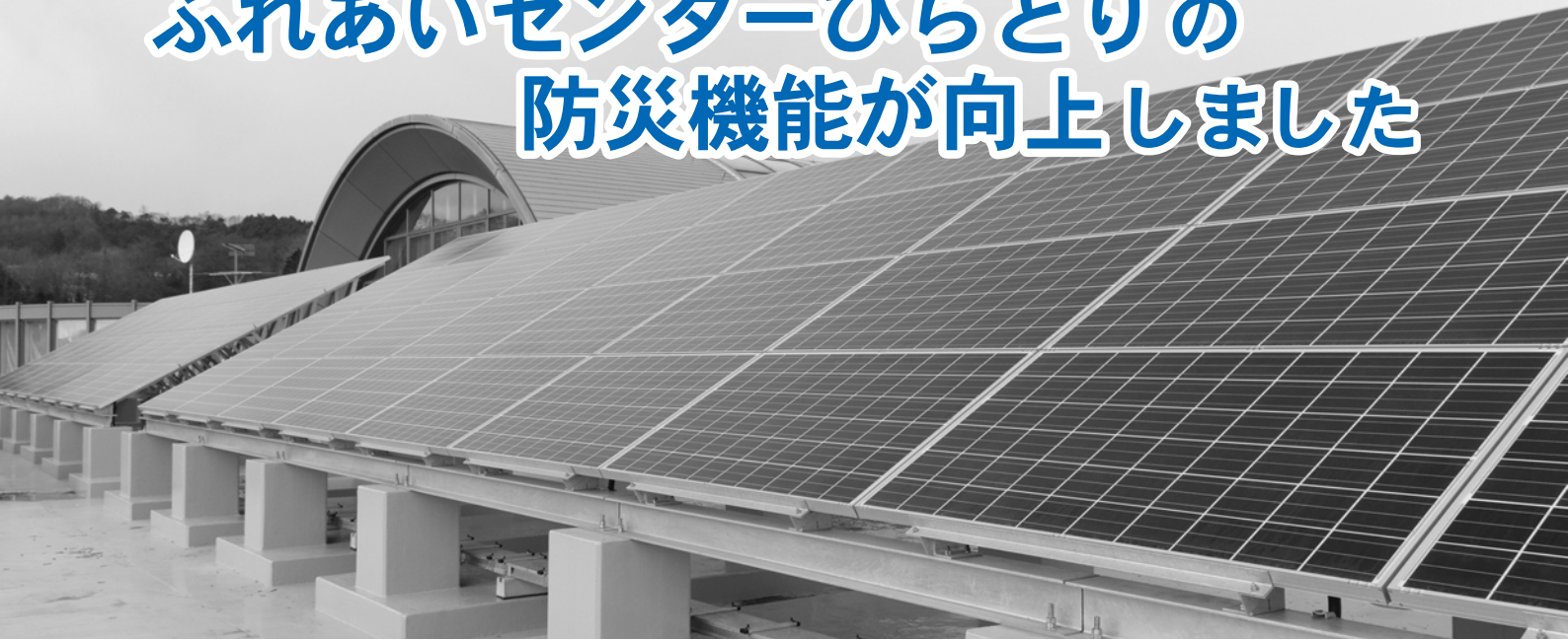
↑ふれあいセンターびらとりの屋上に設置された 19.1kW の太陽光パネル
