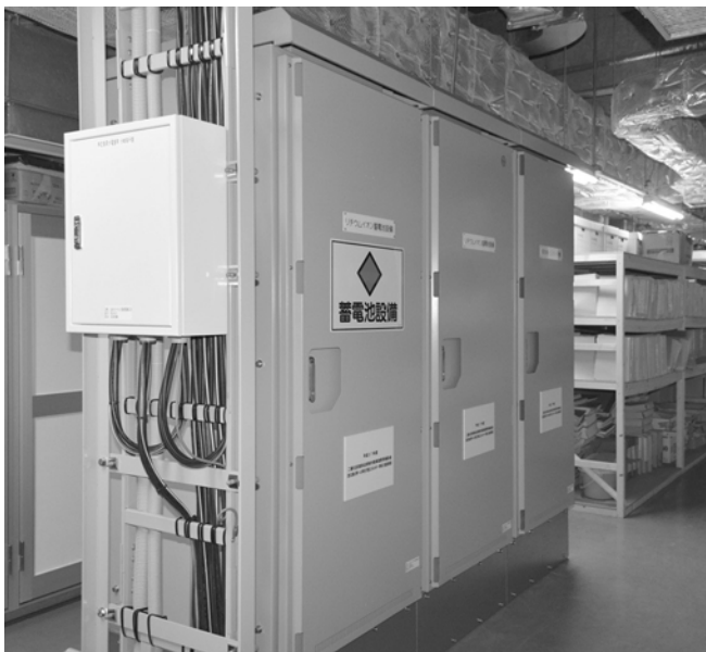
↑施設の地下書庫に設置された蓄電池
