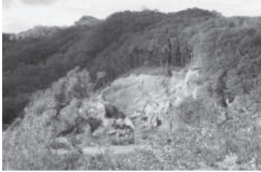
地震による崩落（荷負）
