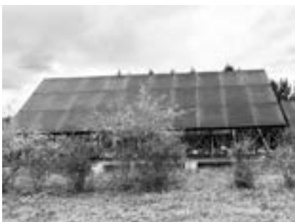
△太陽光パネル
