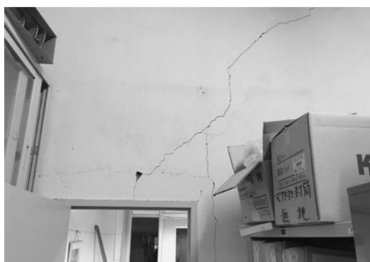
△役場庁舎壁のひび割れ
