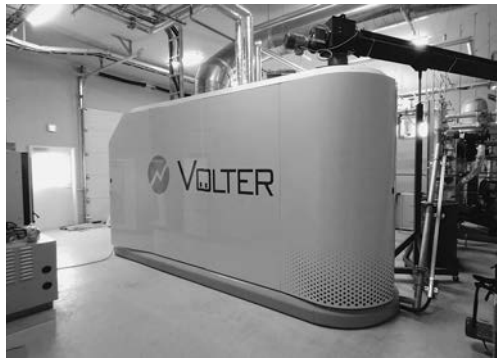
△木質バイオマスセンター熱電併給機
